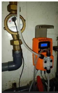
Figuur 5. Doseerinstallatie op waterleiding voor toevoeging zuurstof aan het water.
